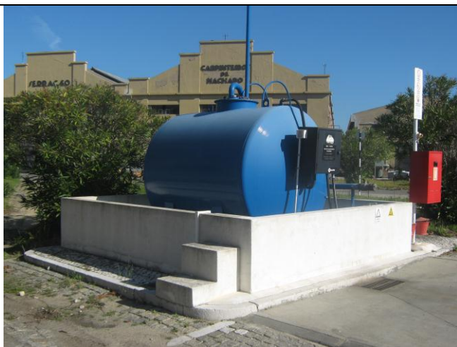
Figura 160: Depósito de gasóleo
