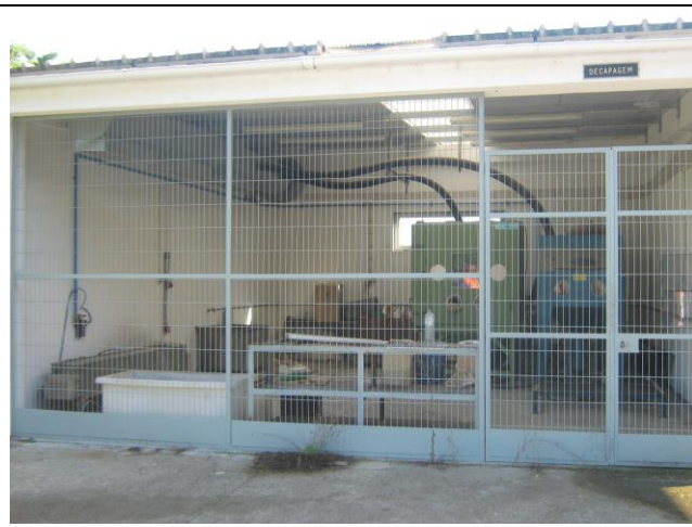
Figura 163: Tina existente na fosfatação
